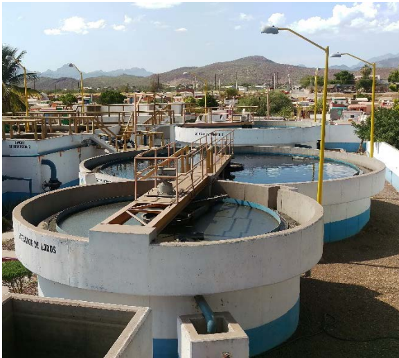
Fotografía 4. Planta de tratamiento de aguas residuales en Loreto, Mpio de Loreto, B.C.S.
